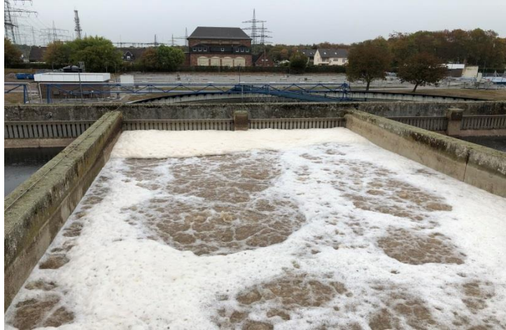
Filterkammer des vorhandenen Biofilters
